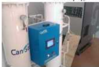
Азотная станция, освободившая участок от разгрузки баллонов с азотом
